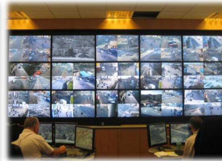
ระบบควบคุมการจราจร
