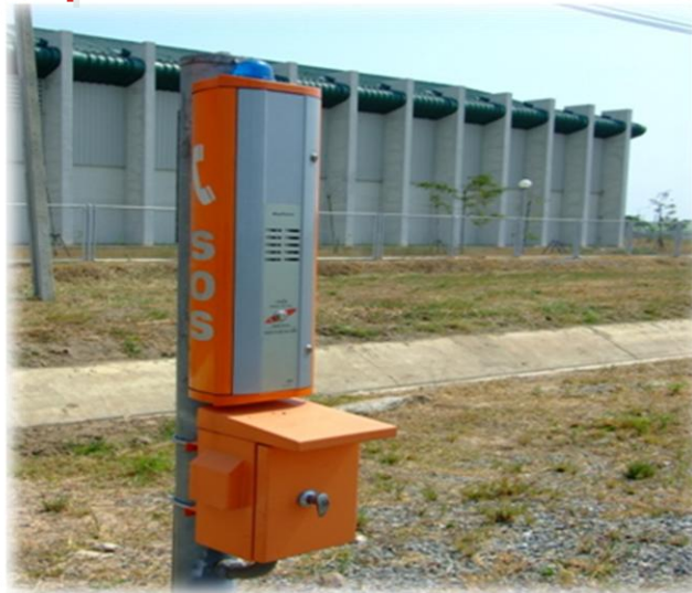
ระบบโทรศัพท์ฉุกเฉิน
